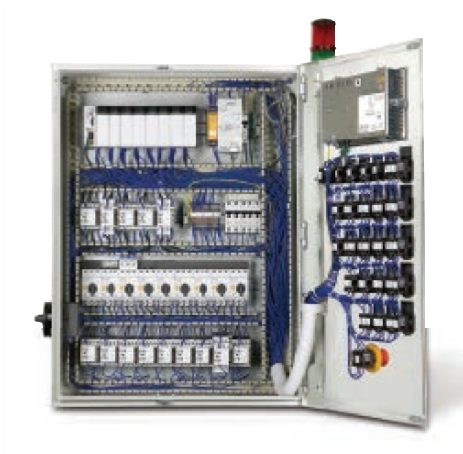
Armoire avec câblage traditionnel
