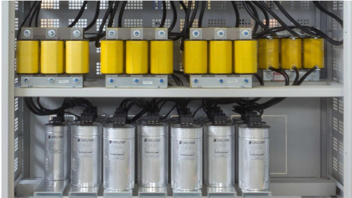
Fig. 11, Batteries de condensateurs avec des filtres de rejet ou décalés
